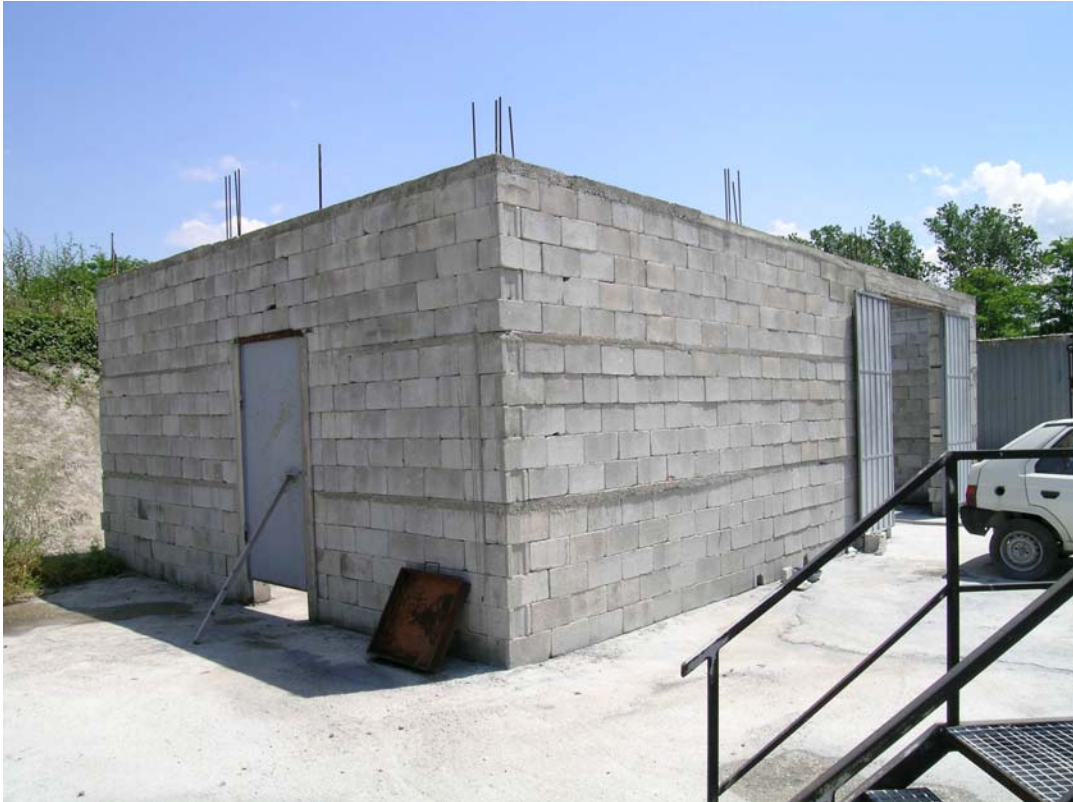
FOTO N.11: Costruzione abusiva sequestrata, località Paduni.
