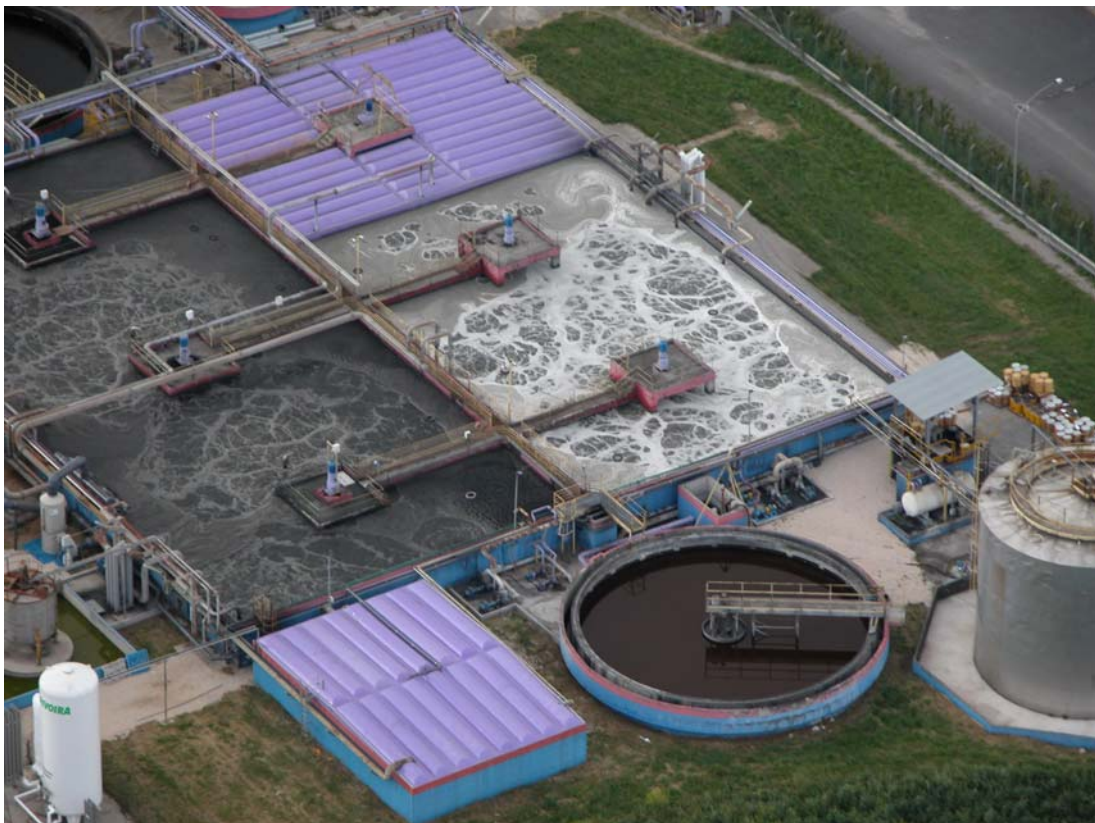
FOTO N.2: Depuratore comunale di Anagni
