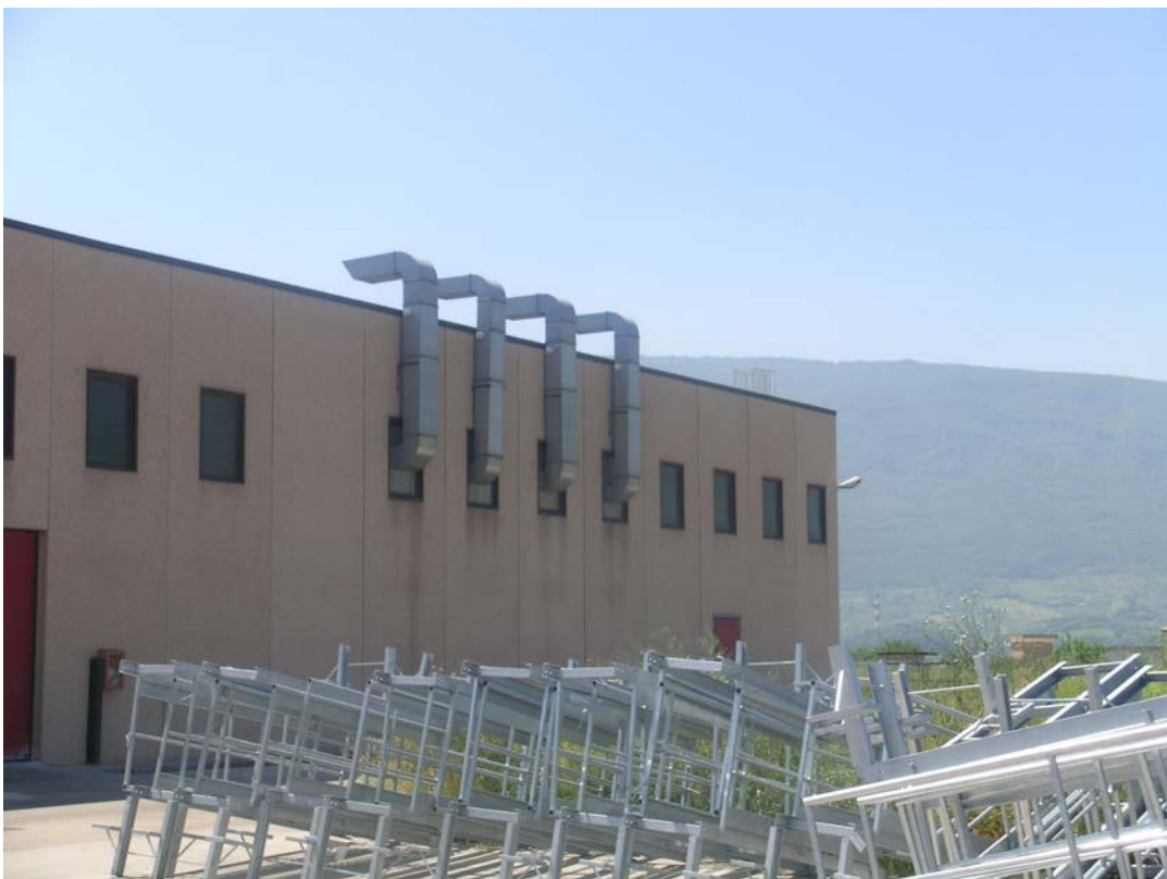
FOTO N.12: Emissioni non autorizzate in atmosfera, località Villa Magna
