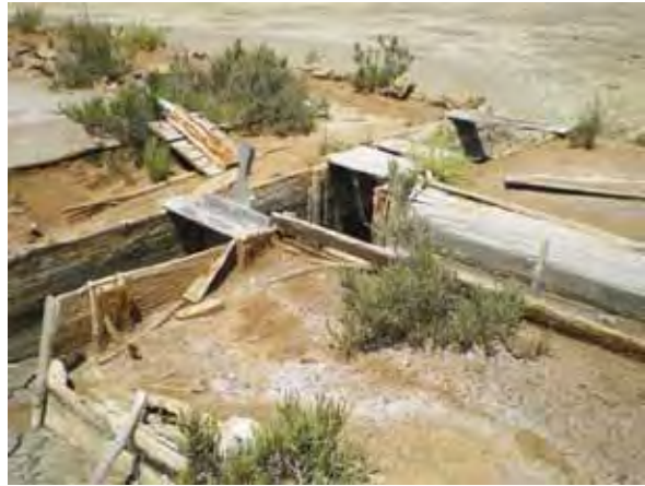
Fig. 19 - Segni di degrado a carico delle strutture di separazione delle vasche e delle canalette in legno d'abete (Foto di M. Scarici).
